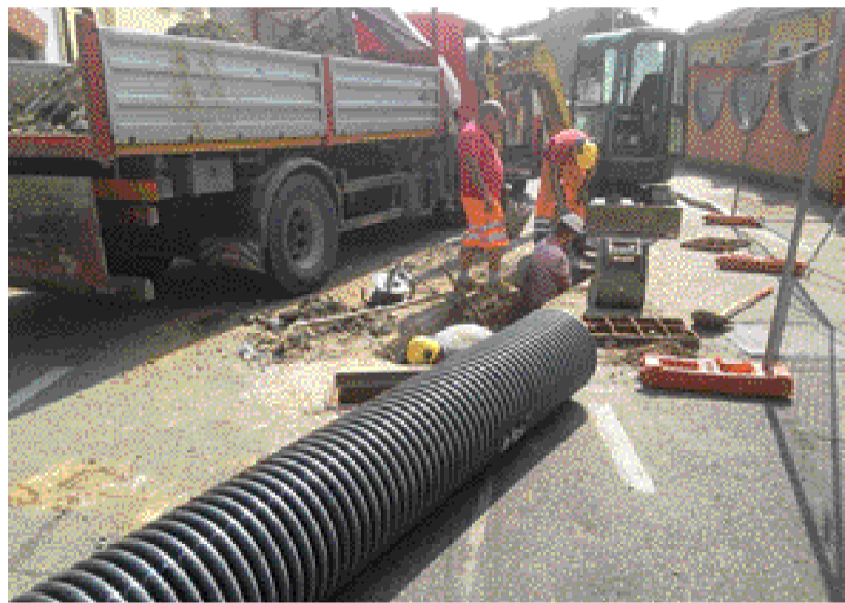
I lavori di ripristino della rete fognaria di via Novara dopo i copiosi temporali estivi
